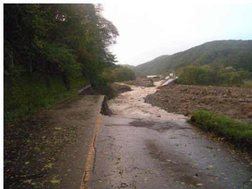
図19 台風19号による被害
